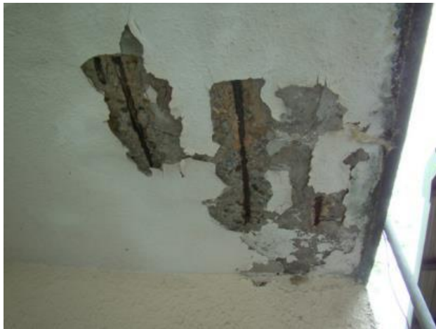
ボロボロになった コンクリートの天井
