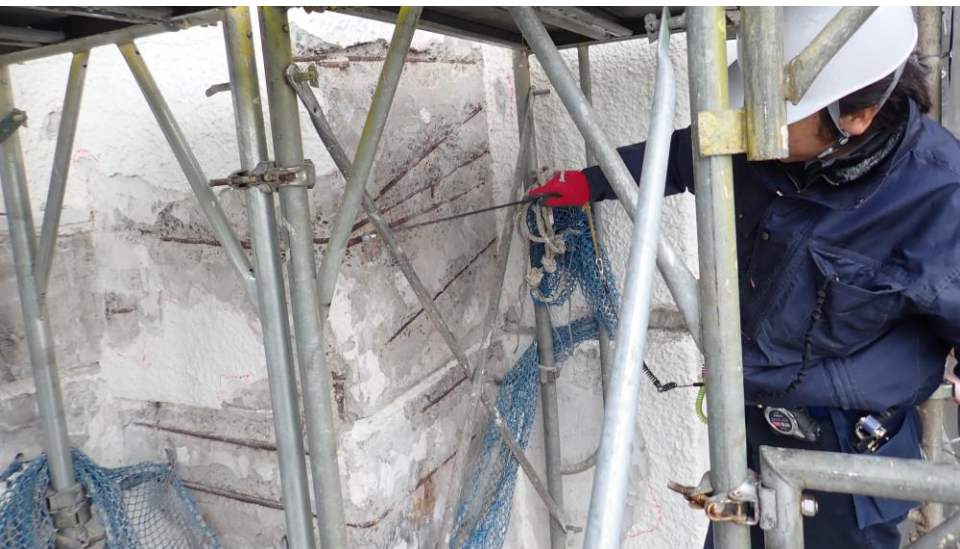
躯体劣化（物理的劣化）
